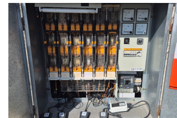
Abb. 2: Ein ganzheitlicher Blick auf die Station: von der Trafobelastung bis zum einzelnen Abgang.
