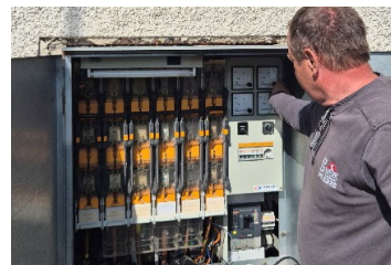
Abb. 1: Einbau der SMIGHT Grid2 in einer ausgewählten Trafostation.
